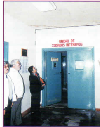
Foto 18. Averías en las redes de agua del Hospital Hipólito Unanue, Tacna.
