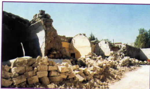
Foto 23. Vivienda de sillar colapsada en Arequipa.
