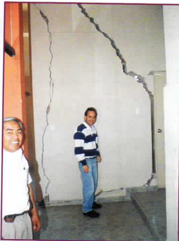
Foto 37. Daños en el Edificio de Registros Públicos de Moquegua.
