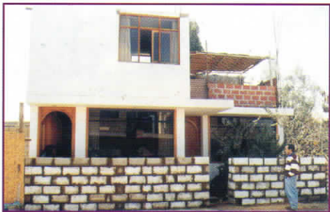
Foto 29. Vivienda sin daños a pocos metros de vivienda con daño irreparable.
