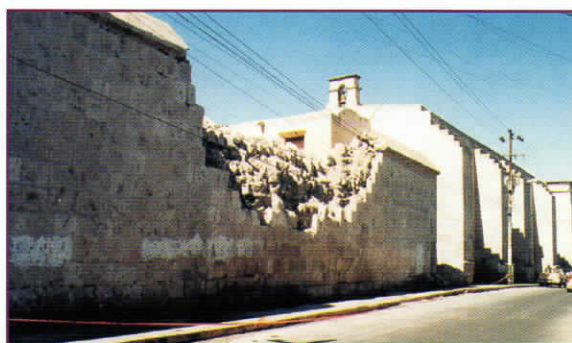
Foto 34. Daños en el muro perimetral en la Iglesia de Santa Teresa, Arequipa.
