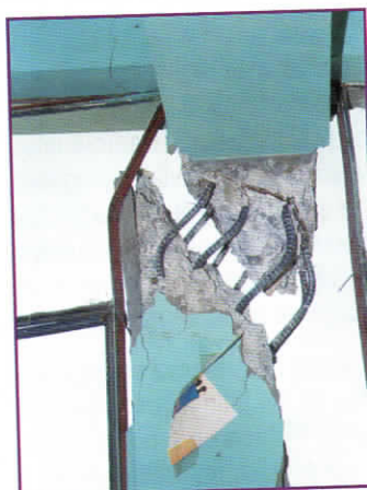
Foto 6. Falla de cortante en columna exterior del Centro Educativo Angela Barrios, Moquegua.
