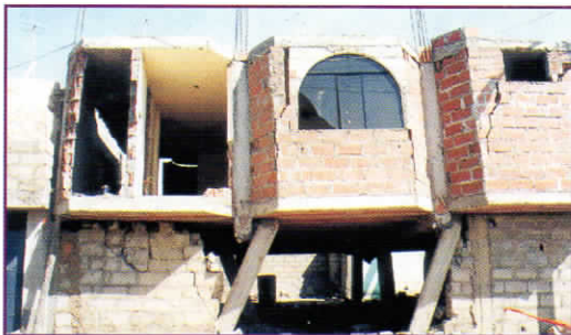
Foto 28. Falla por mecanismo de piso blando en una vivienda en Tacna.
