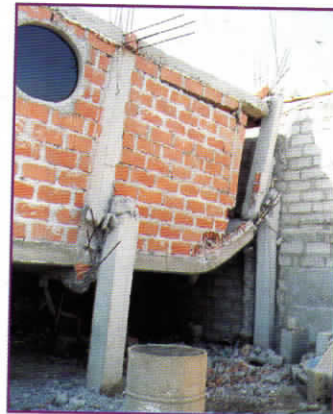
Fotos 26 y 27. Viviendas de albañilería y concreto armado con daño irreparable, Tacna.
