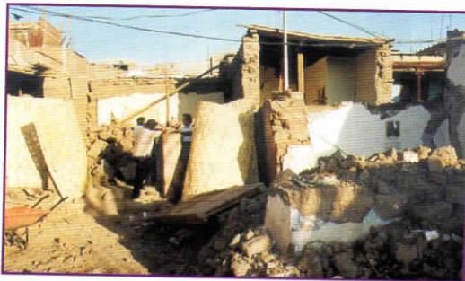
Foto 22. Colapso de viviendas de adobe en Moquegua
