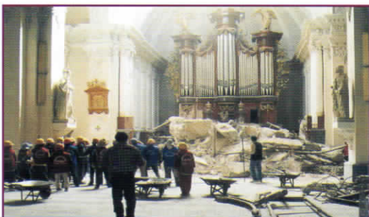
Foto 31. La torre izquierda de la Catedral de Arequipa perforó el techo en su caída.
