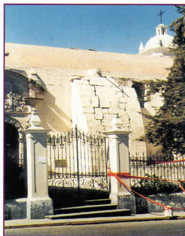
Foto 33. Grietas en los contrafuertes en la Iglesia Santa Marta de Arequipa, al controlar el movimiento del cuerpo central.
