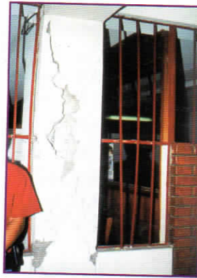
Foto 12. Daño típico de columna corta en edificios de la Universidad Nacional San Agustín de Arequipa.
