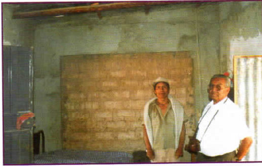
Foto 39. Reforzamiento de viviendas de adobe existentes empleando franjas de malla electrosoldada tarrajada, poblado de Yacango, Moquegua.
