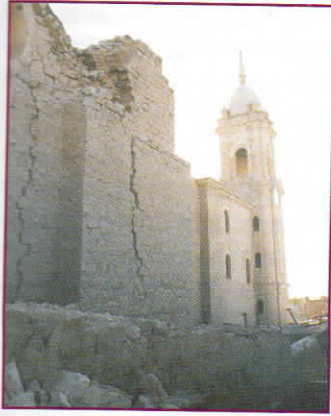
Foto 35. Daños importantes en la Co-Catedral de Moquegua.
