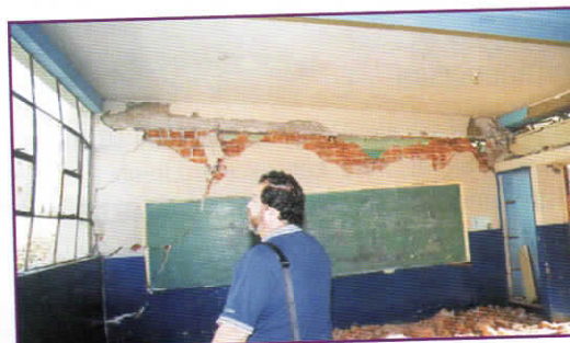
Foto 5. Falla de columna corta con pérdida de altura en todas las columnas interiores (a la derecha) del Centro Educativo Angela Barrios, Moquegua.
