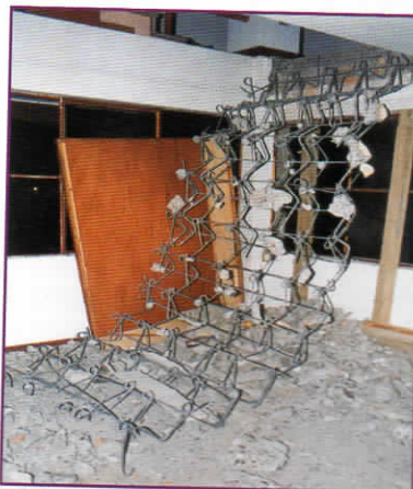
Foto 14. Colapso de una escalera tipo alfombra al verse solicitada axialmente, Universidad San Agustín de Arequipa.
