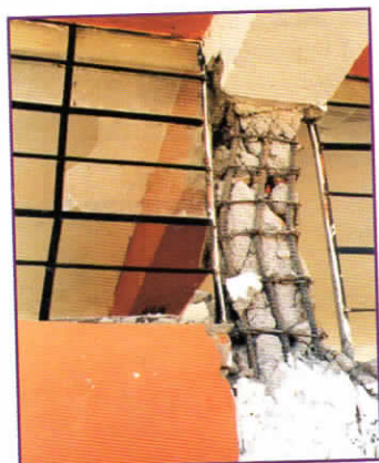
Foto 2. Falla de columna corta en un pabellón del Centro Educativo Casimiro Cuadros, Arequipa.
