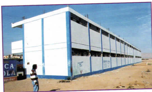
Foto 3. Falla en todas las columnas del primer piso por el problema de columna-corta, Centro Educativo Mariscal Cáceres, Tacna.
