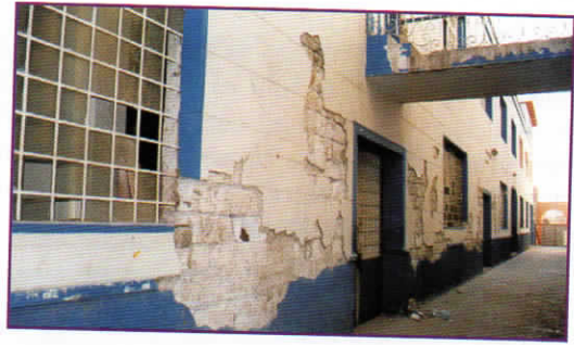
Foto 11. Daños menores en antiguo local del Colegio Salesiano de Arequipa
