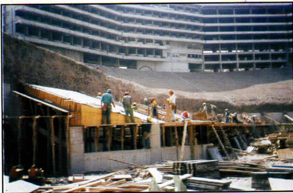
Figura 19. Detalle constructivo en la zona de Vestuarios. Nótese el pórtico transversal que resistirá, además de las cargas de gravedad, el empuje del terreno.
